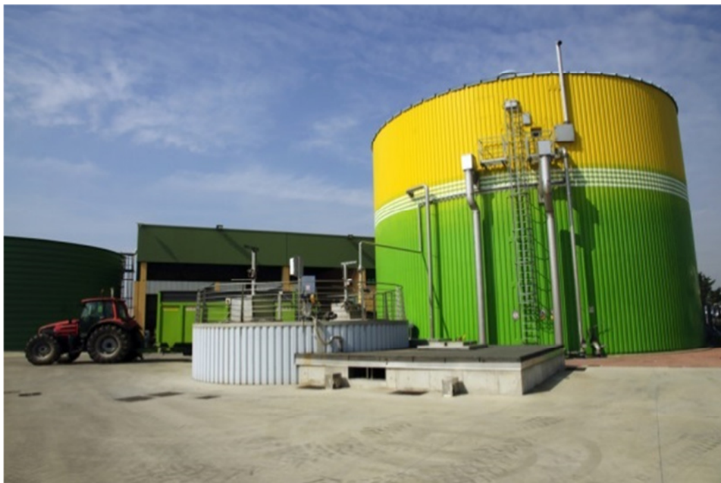
Abbildung 11: Biogasspeicher; Quelle: Shutterstock Bildergalerie; Urheber: Moreno Soppelsa
